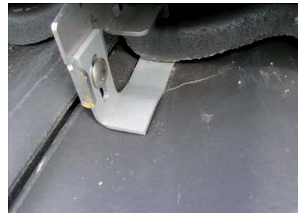
Praktijksituatie gebroken dakpan door puntbelasting van dakhaak
